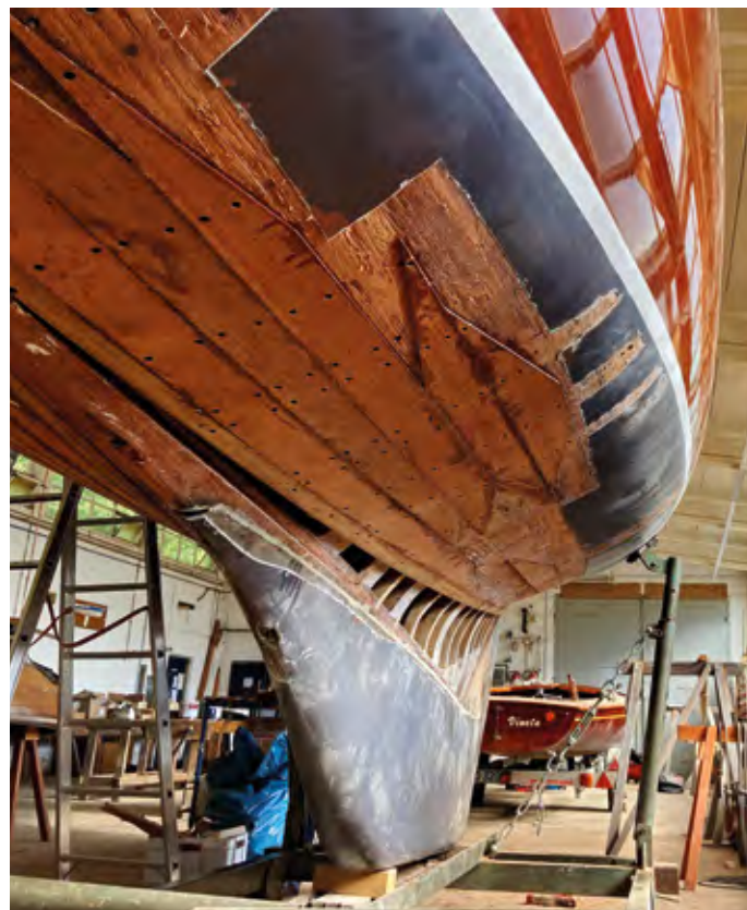
Von innen nach außen. Nachdem im Rumpf Spanten und Wrangen erneuert wurden, wird der Rumpf wieder geschlossen.
